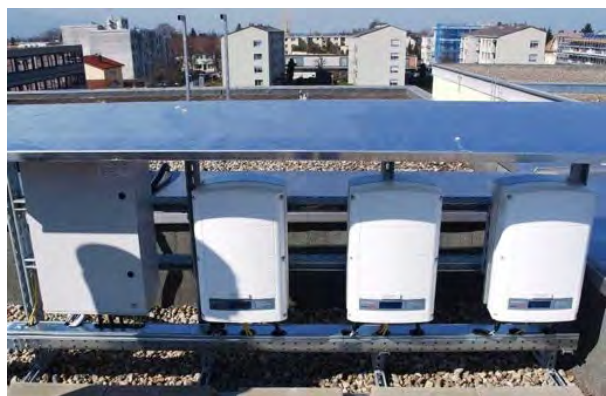
Fig. 39 - Inverter e quadri di campo posizionati su apposite strutture metalliche di sostegno.
